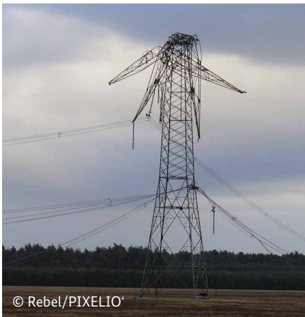
Sturmschaden durch den Orkan Kyrill im Jahr 2007
